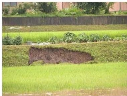
法面の崩壊状況
